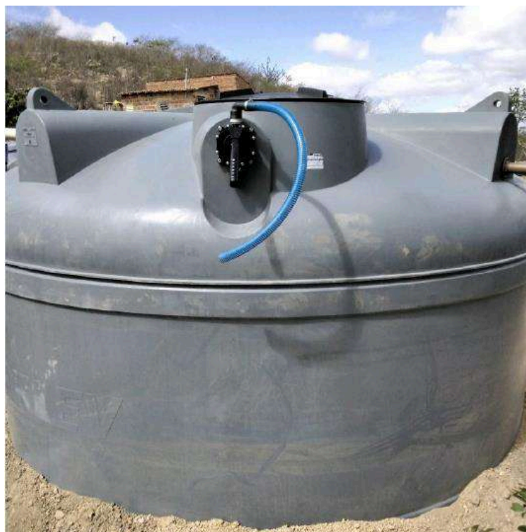
Figura 5: Exemplo de Cisterna de 16.000L instalada.
